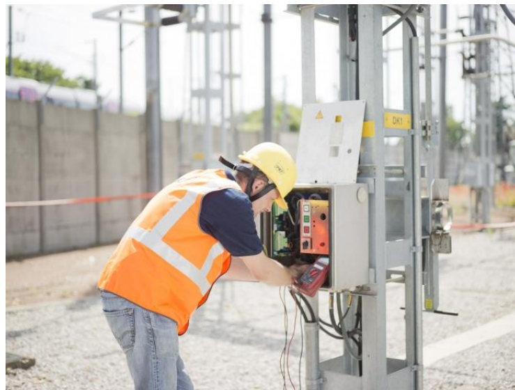
Technicien entretenant les installations électriques / © Médiathèque SNCF A.TOUBIANA
